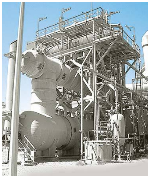
Рис. 72. Колонна синтеза аммиака
